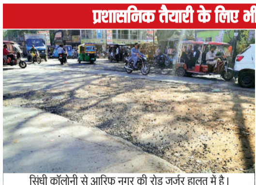
सिंधी कॉलोनी से आरिफ नगर की रोड जर्जर हालत में है।
