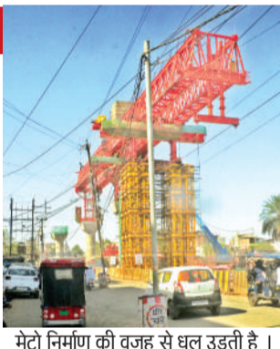
मेट्रो निर्माण की जगह से धूल उड़ती है।
